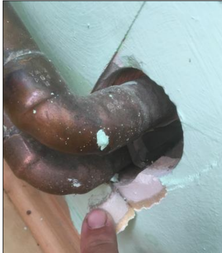
Слика 7. Радијаторске цеви које откривају попречни пресек унутрашњег зида у постојећој згради (фото: С. Сушић)
