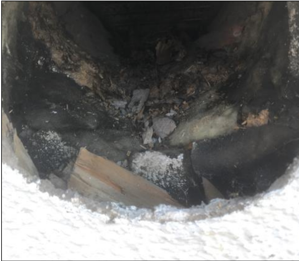
Слика 10. Отвор за вентилацију с попречним пресеком изолационе фасадне плоче која садржи азбест (фото: С. Сушић)
