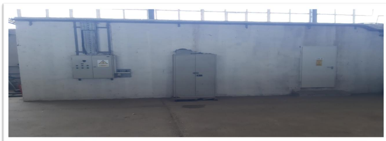
Слика бр.9 - Трафо-станција ТС-9
